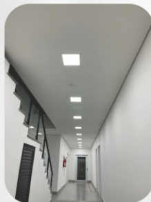
Forro em Drywall
